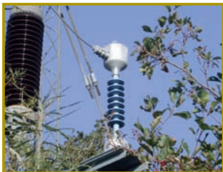
OPGW tilgang til Rømø.
