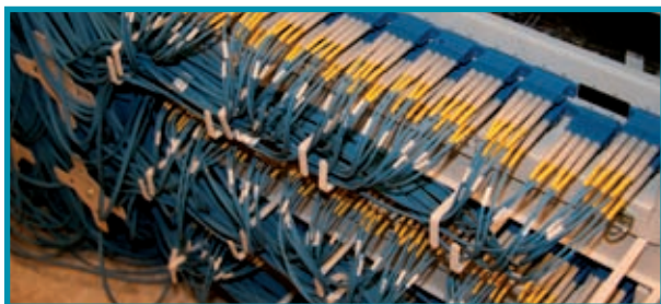
Krydsfelt med LC konnekter Her er der tale om patch kabler på vej til det aktive udstyr
